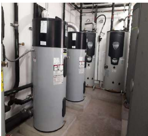
Imagen 27. Bombas de calor y calderas para sistema de respaldo de ACS.
