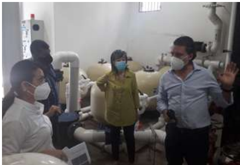
Imagen 20. Visitas técnicas al sitio donde se instalarán los equipos para el sistema de climatización.
