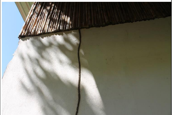
Ataque de comején se recomienda fumigación general antes de instalar
