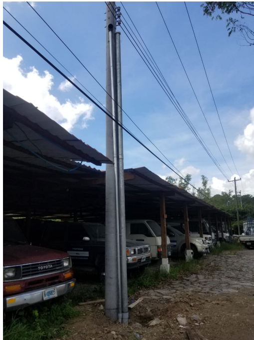
Imagen 9. Ductos de Acometida Eléctrica
