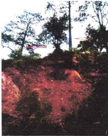
Fig. 7. Se indican algunas rocas de gran tamaño que están contenidas en una matriz de suelo inestable, susceptible a la lluvia que podrían deslizarse en cualquier momento. De igual manera se indican algunos árboles de gran tamaño que de ocurrir algún movimiento en el talud, podrían caer sobre la vivienda y ocasionar algún daño severo a los habitantes de la misma.
