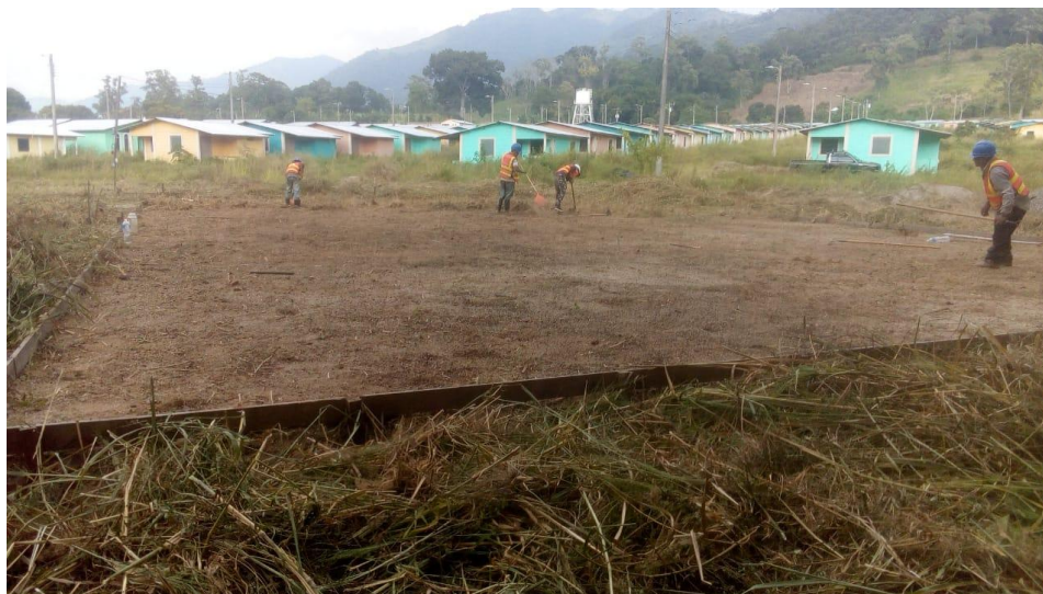
Descapotado de área de terreno donde se construye el “Parque para Una Vida Mejor”
