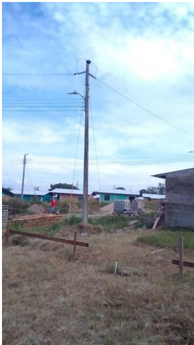
Retenida de Poste de tendido eléctrico
