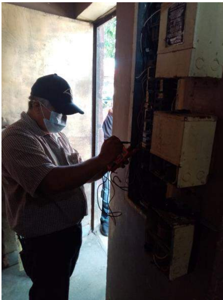
Revisando el voltaje de la bomba en el parque central.
