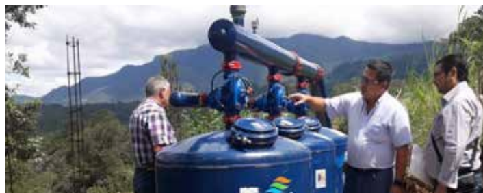
SAG-PROLENCA. Bomba instalada para sistema de Riego de Belén, Lempira.
