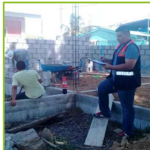
Orden de Paro a construcción sin permiso.
