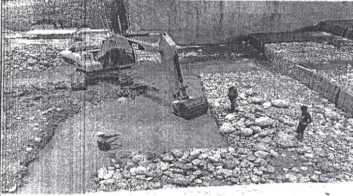
Reparación de gavión caja y vista de muro de concreto armado presa N. 2
