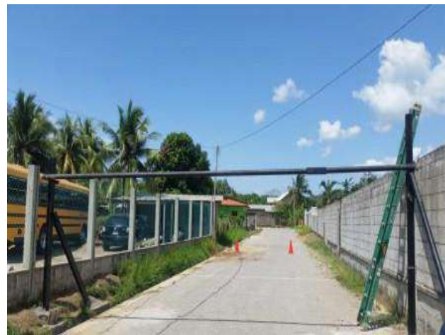
La Escuela Taller Municipal “Elio Henríquez” realizó la elaboración e instalación de medidor de altura, solicitud hecha por patronato del barrio cieneguita la cual fue aprobada por la alcaldía
