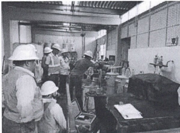
Medicion de voltaje ya en conexión:
