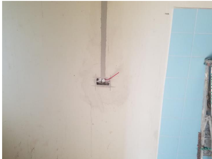
Imagen 5. Instalaciones de cableado para tomas
