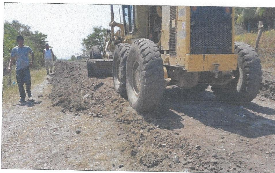
Reparación de calles en varias comunidades del Sector Este C del Municipio
