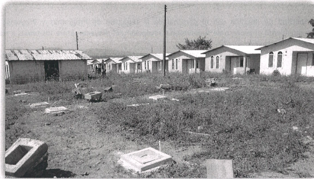
Fotografía XIII "Subsanación de la profundidad de las cajas de registro que presentaban poca profundidad"
