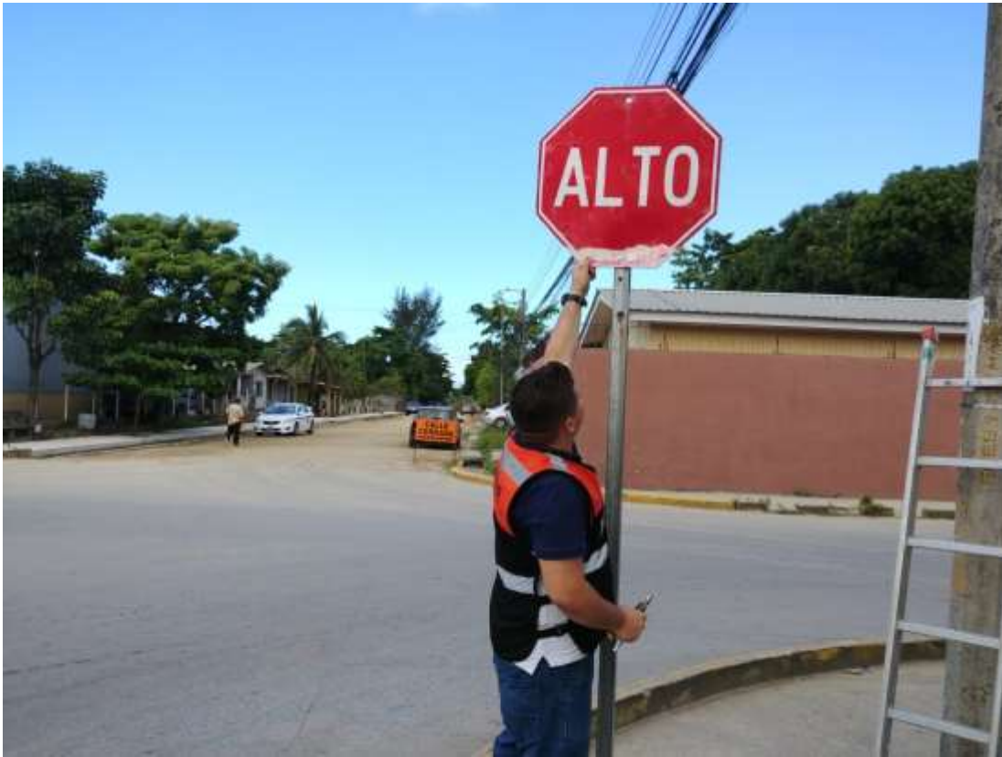
Reparación de señal de ALTO en la 2 calle 6 avenida B. El Centro
