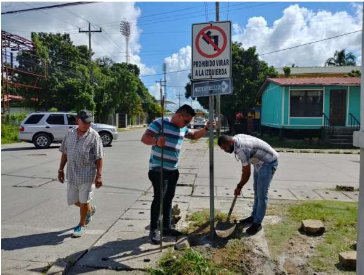
Reparación de señal PROHIBIDO VIRAR A LA IZQUIERDA EN B. Copen 8 calle 4 avenida
