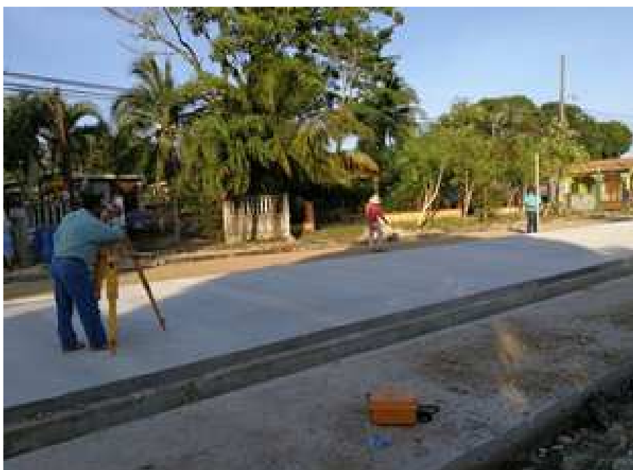
REVISION Y SUPERVISION DE NIVELES DE PAVIMENTACION 5ª AVENIDA, ENTRE 1 Y 2 CALLE ESTE
