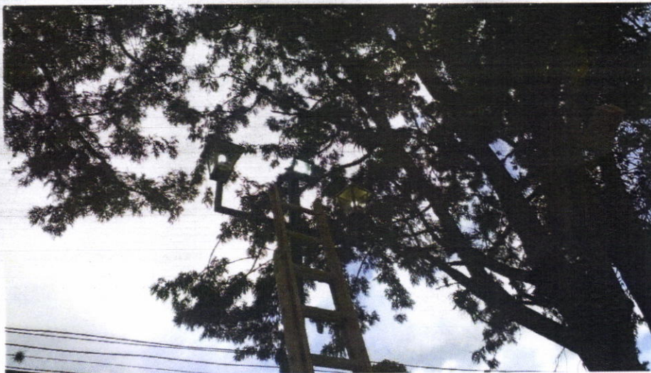
Imagen muestra la colocación de faroles y bombillos
