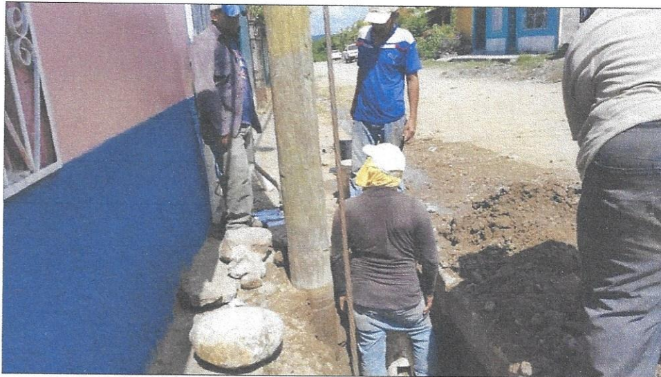
Cambio de válvulas de agua potable, Colonia Colinas de Canadá Sector Este C
