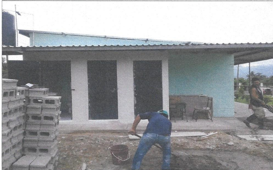
Construcción de baños en Escuela de Colonia Flor del Campo, Municipalidad-Confecciones Dos Caminos Fruit Of The Loom
