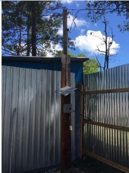
Imagen 4. Instalación provisional eléctrica.
