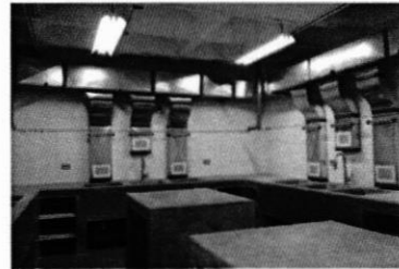
Sistema de extracción en cuarto oscuro, Laboratorio de Rayos X
