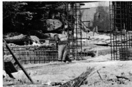
Armado de hierro de las vigas VR del portal peatonal este del lado izquierdo.
