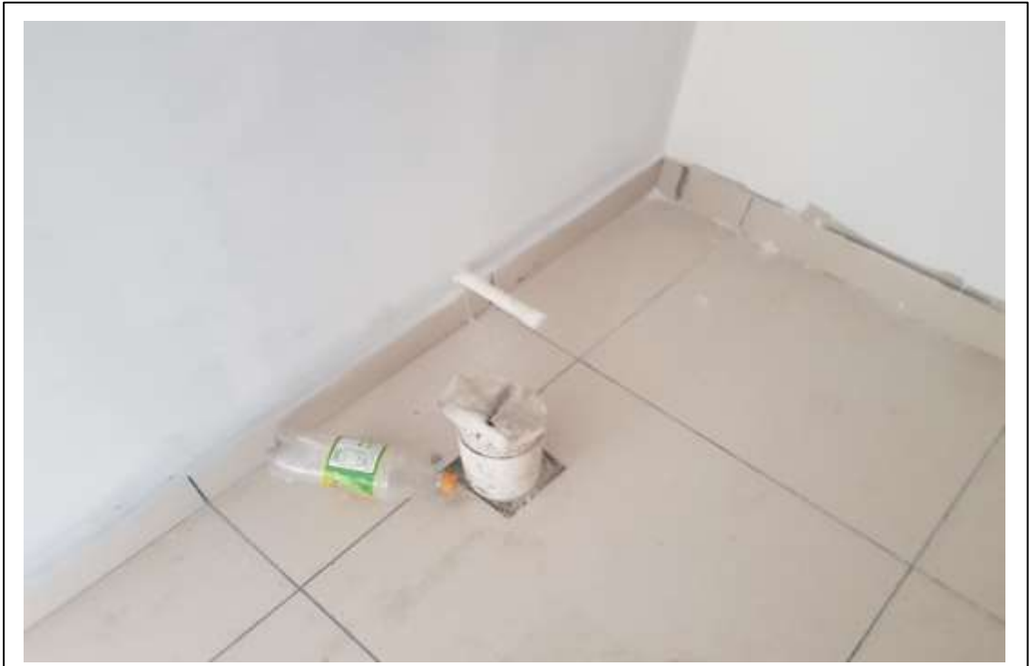
Tubería de PVC de 4"
