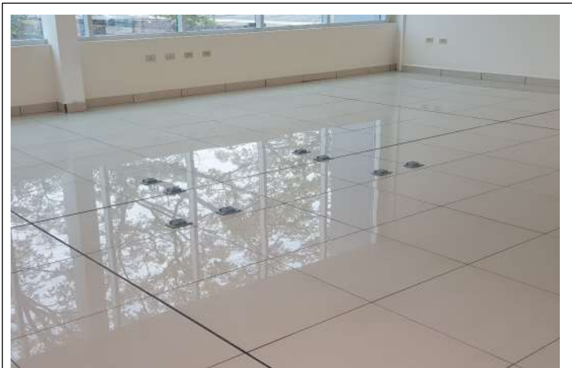
Tomacorrientes en Piso
