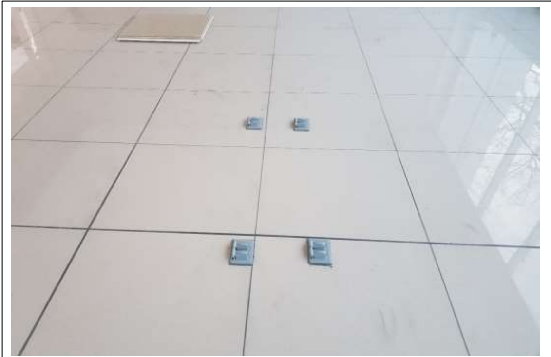
Tomacorrientes en Piso
