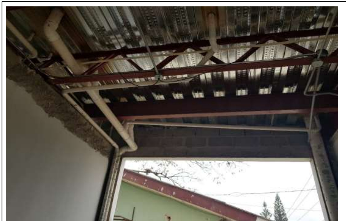
Tubería de PVC de 2"
