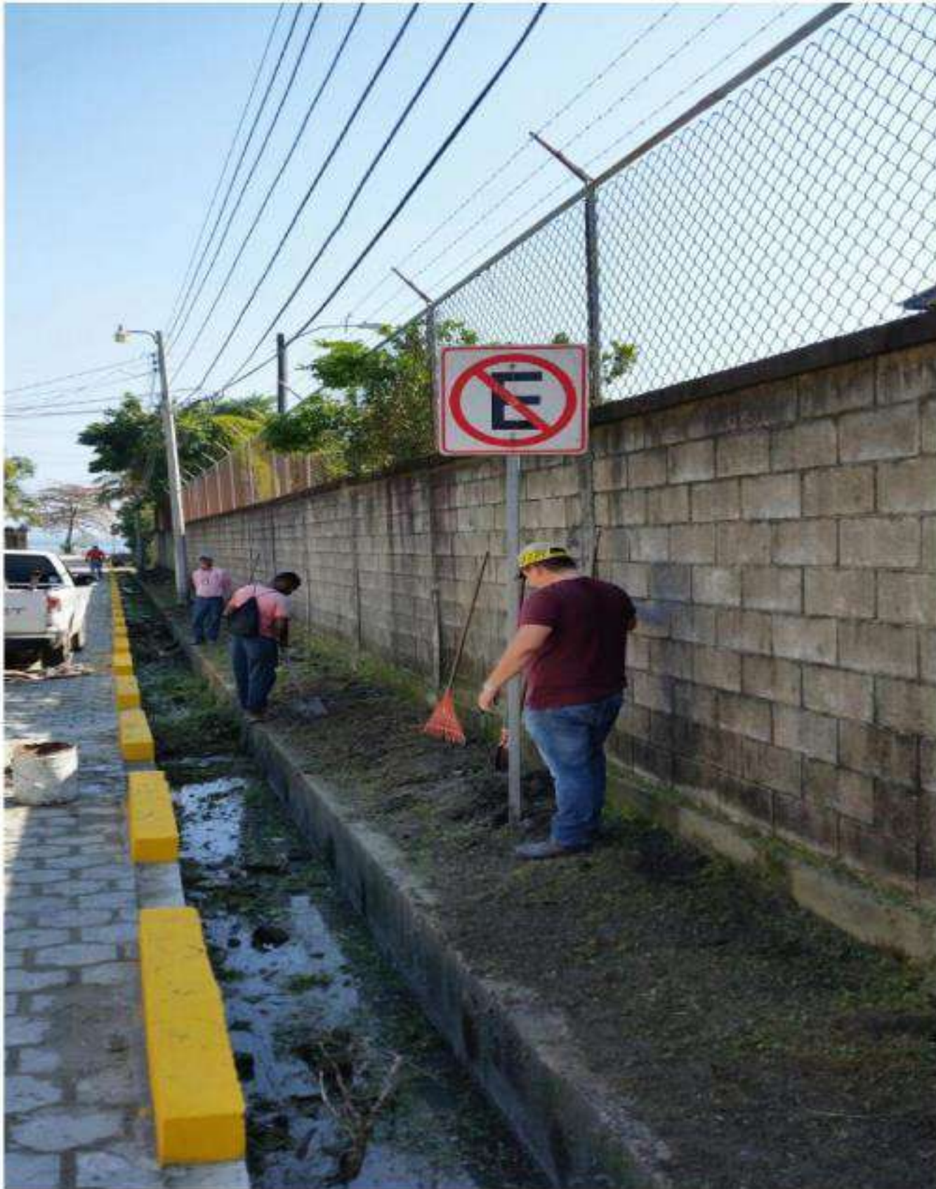
Instalación de señal de no estacionar en el adoquinado Barrio la curva frente al portón n.1 de OPC.
