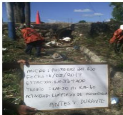
MAMV: Palmeras del Río. Tramo: Ruta 15, Est. 30+000 – Río Dulce Est. 60+000, del Depto. de Francisco Morazán.
