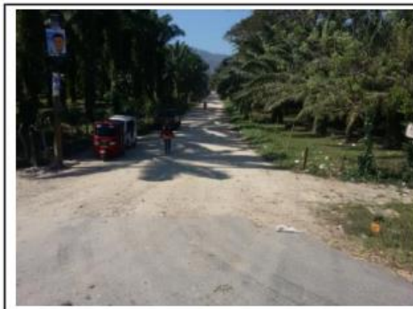
No. Tramo: RUTA CA. 13 - PLANES DE HICAQUE Estación: 0+000 1 Actividad: Conformación Tipo I Fecha: 05/05/17
