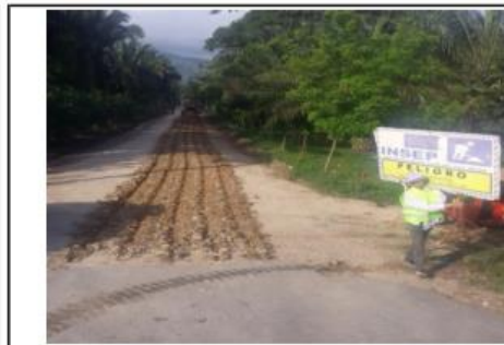
No. Tramo: RUTA CA. 13 - PLANES DE HICAQUE Estación: 0+000 2 Actividad: Conformación Tipo I Fecha: 05/05/17
