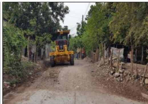
No. TRAMO: Itame-San Juan de La Cruz-San Jose de Oriente Estación: 0+000 12 Actividad: Reacondicionamiento de Calzada Fecha: 09-05-2017
