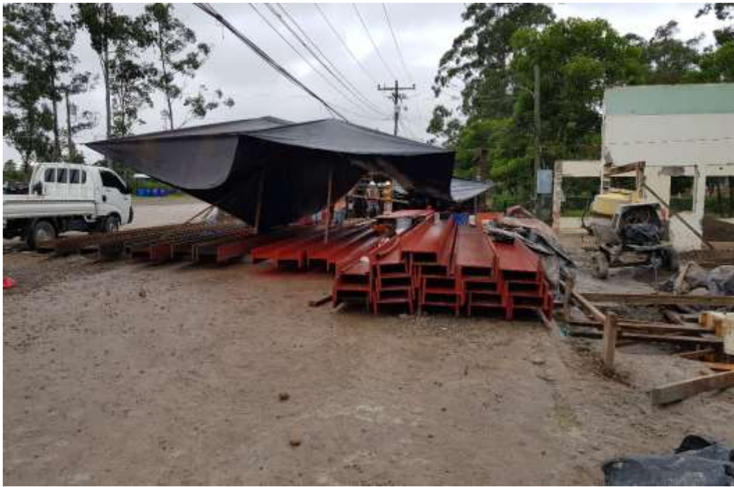
Anticorrosivo Color rojo
