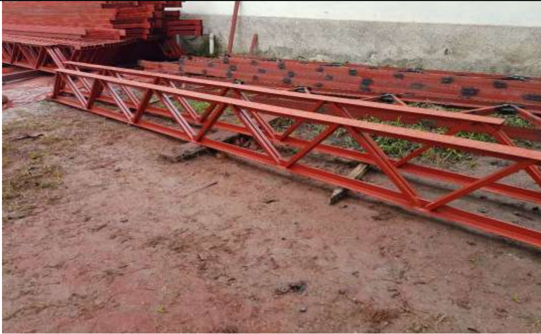
Anticorrosivo Color rojo
