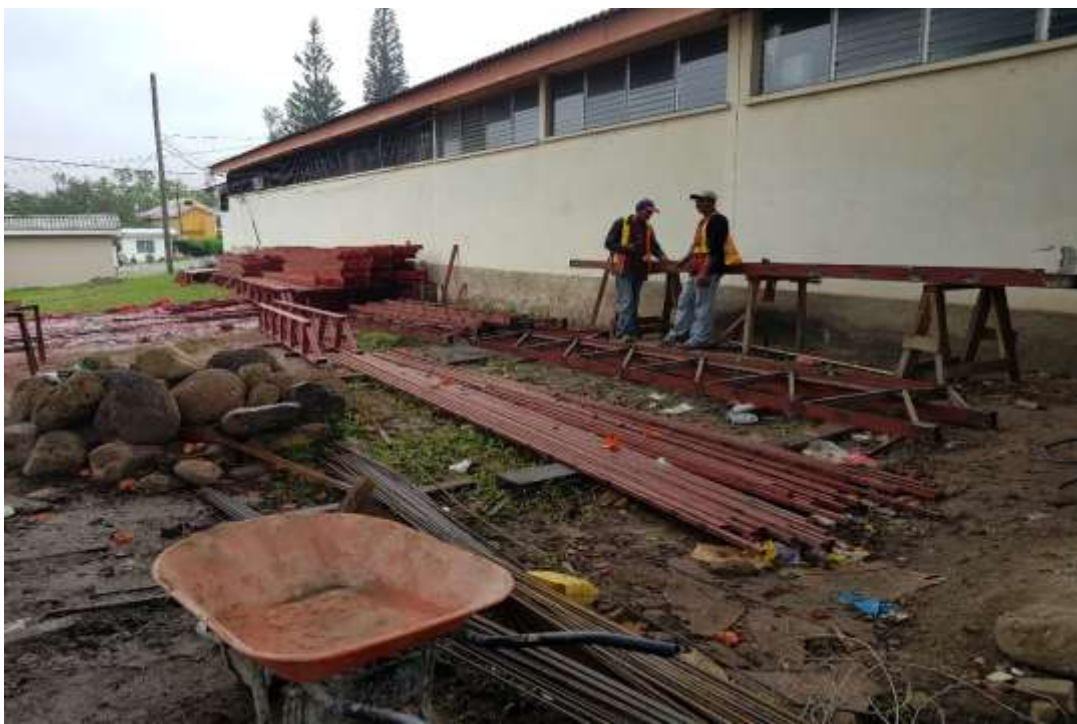
Anticorrosivo Color rojo
