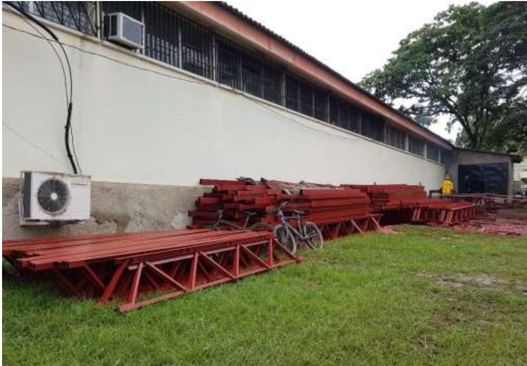
Anticorrosivo Color rojo
