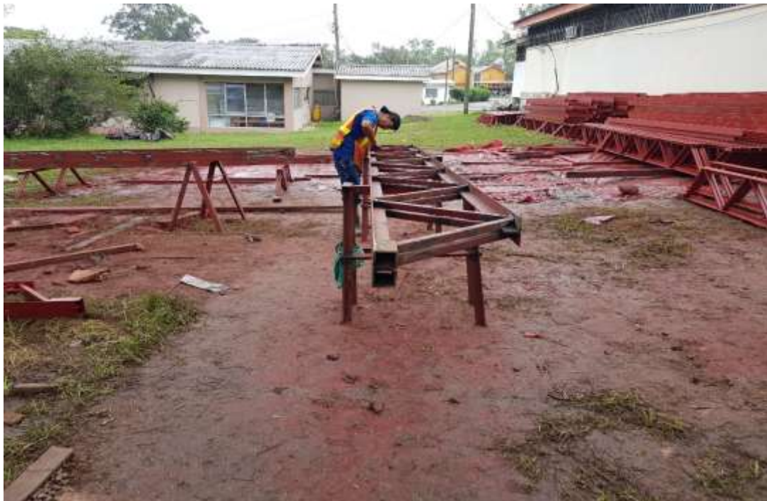
Anticorrosivo Color rojo
