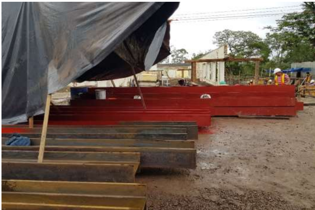
Anticorrosivo Color rojo
