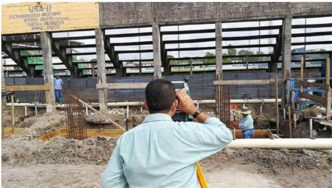
SUPERVISION DE ARMADO Y ENCOFRADO DE ZAPATAS EN PROYECTO DE TECHADO DE CANCHA DE BASQUETBOL
