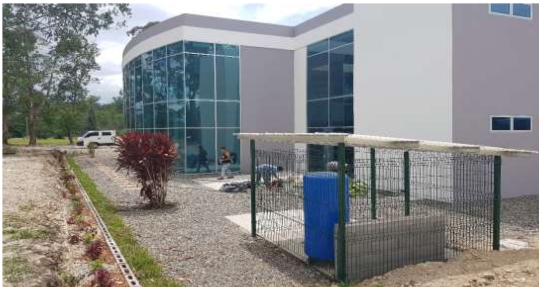
instalación de Bomba con Tanque y Panel sobre cisterna
