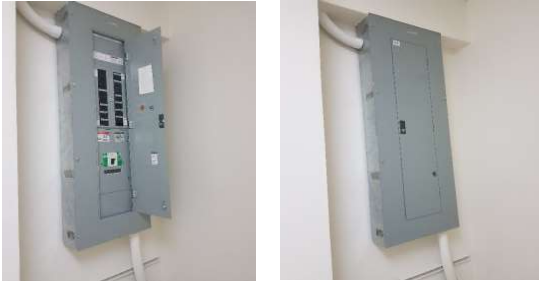
Panel de Distribución con Main Breaker
