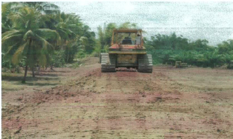
PROYECTO Sobreelevación de bordo margen izquierda del Río Ulúa, aldea Las Brisas, ubicado en el sector El Pantano, jurisdicción de Puerto Cortes, departamento de Cortes, EN EJECUCION
