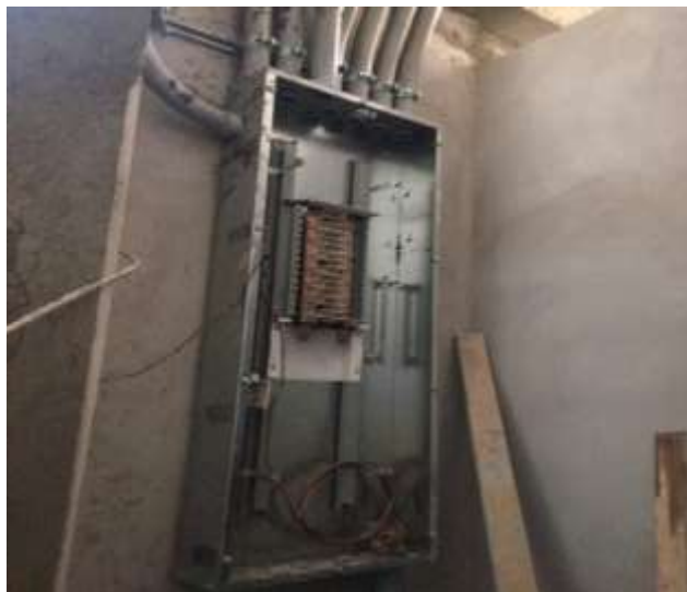
Panel de Distribución con Main Breaker
