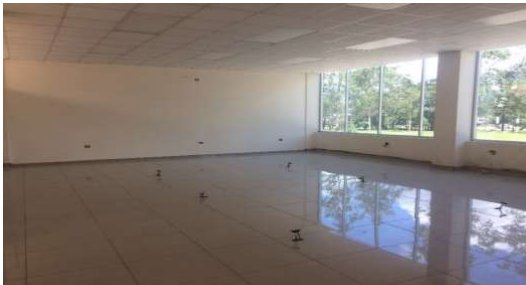
Tomacorrientes en Aulas
