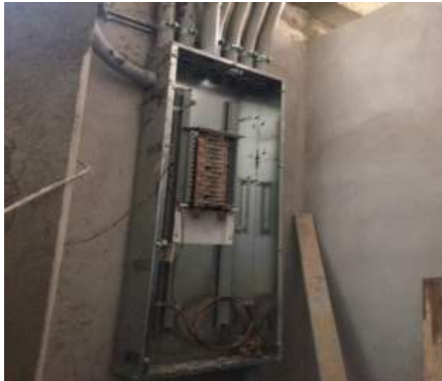
Panel de Distribución con Main Breaker
