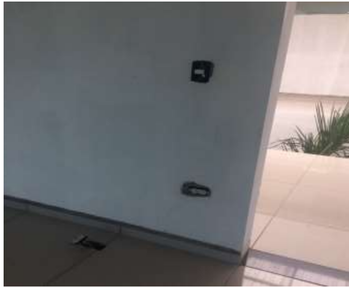
Tomacorrientes y Interruptores en Aulas
