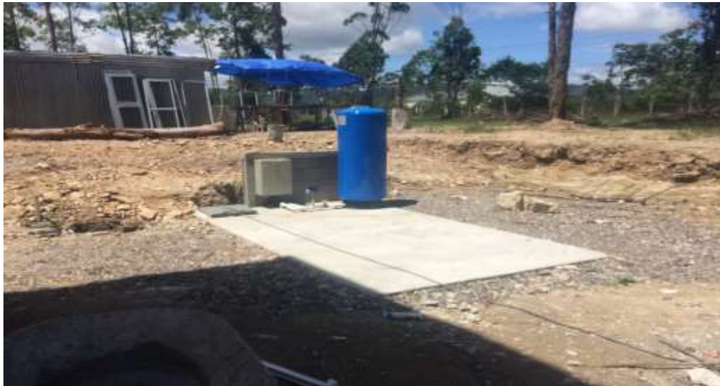
instalación de Bomba con Tanque y Panel sobre cisterna
