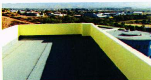
Vista de la impermeabilización en la azotea 2 ejes 1 al 6, se muestra el acabado de pretilas
