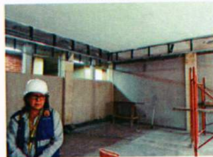
Instalaciones de cajillos, UNAH-VS
