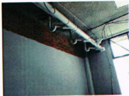
Instalaciones hidrosanitarias, UNAH-VS
