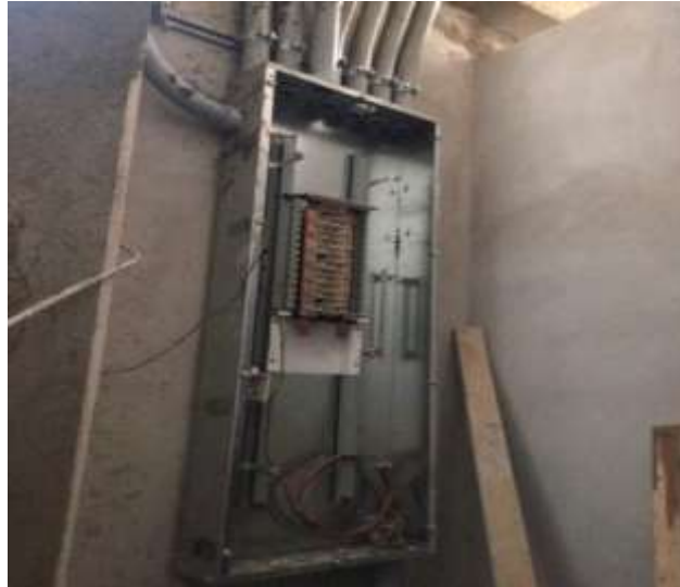
Panel de Distribución con Main Breaker
