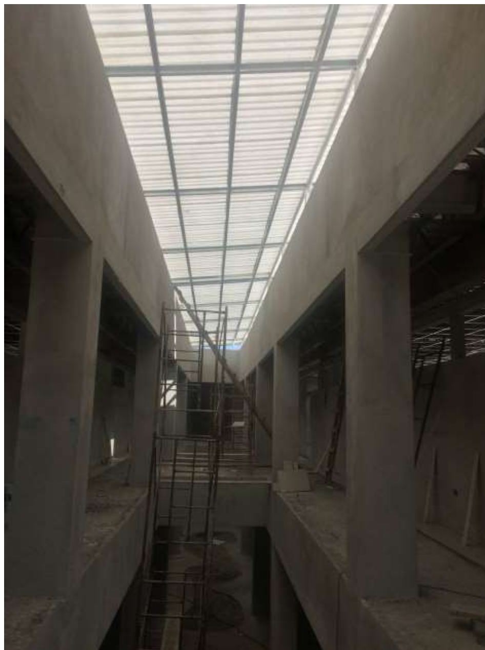
Estructura de Canaleta y Lamina Traslucida
