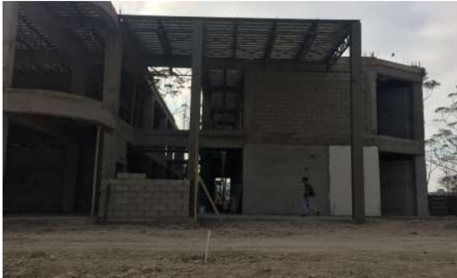
Armado de Joist con cuerda superior e inferior de ángulo doble de 2"x3/16 y diagonales reforzadas de ángulo doble intercalado de 1"1/8" a 45°@ 1 metro
