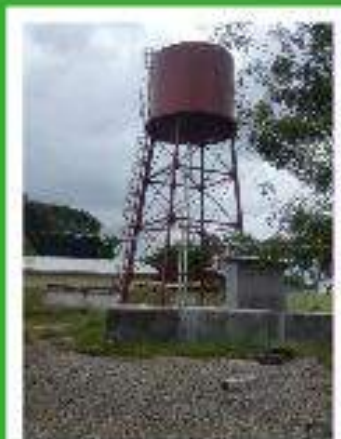
Tanque de distribución en la Comunidad de Kilómetro Seis
