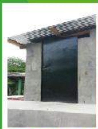
Cisterna en Tanque de distribución en la Comunidad de Kilómetro Seis
