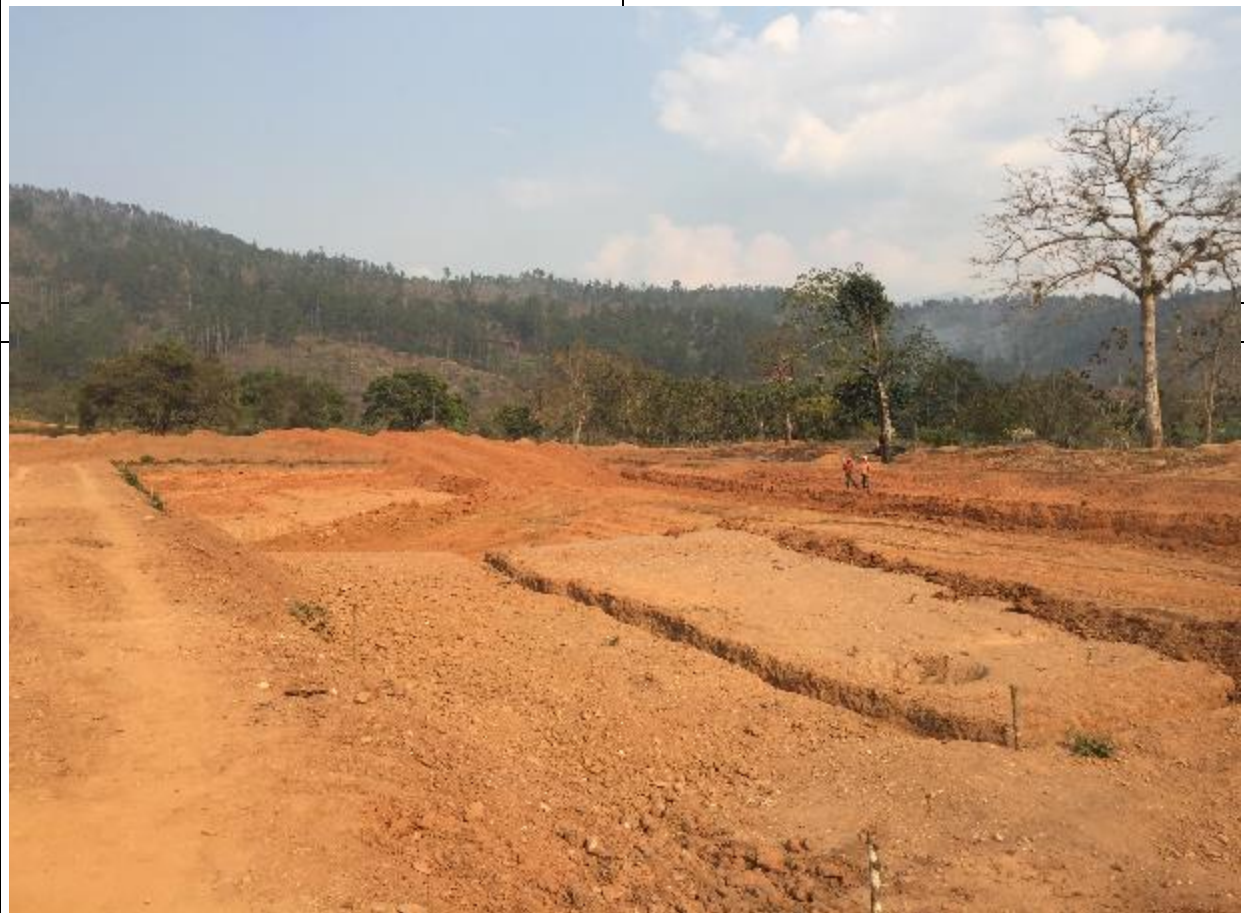
Panorámica general de las lagunas de Oxidación.
