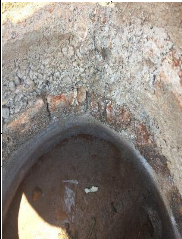
Interior de Pozo mal acabado (Casquete mal construido)
