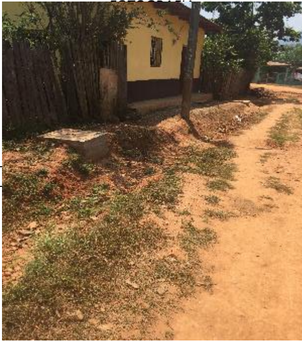
Caja Domiciliaria sin relleno y ubicada en borde de cuneta
