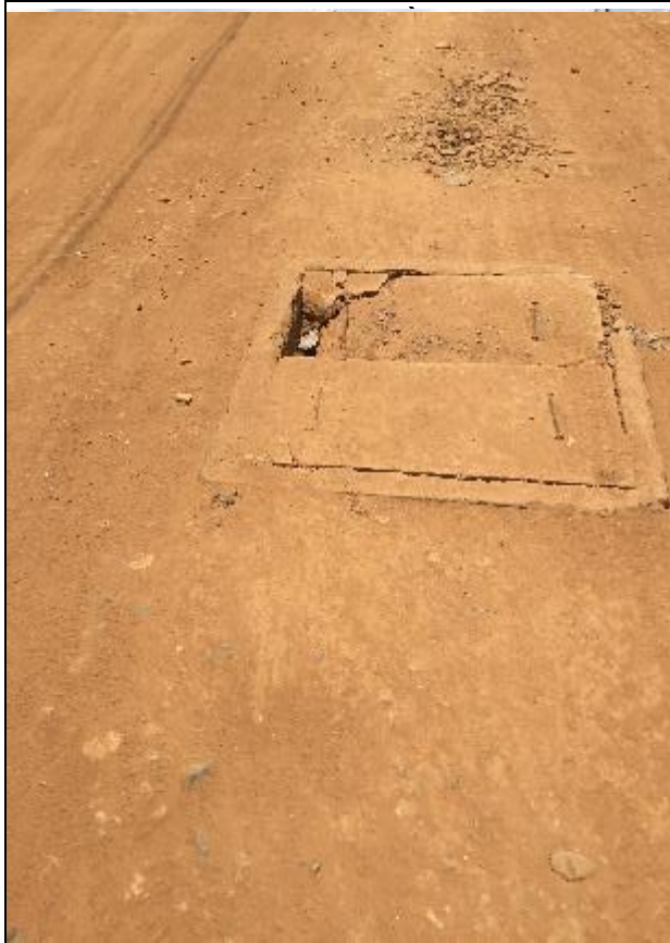
Eaja Domiciliar de Limpieza en esta zona de Quebrada.
