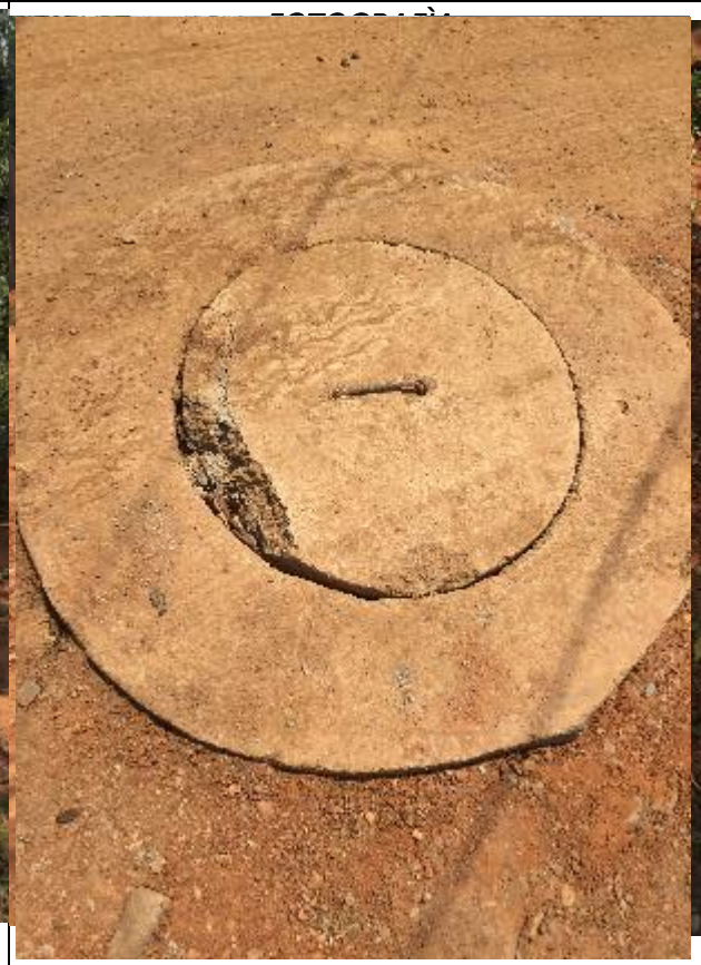
Eaja Domiciliar de Limpieza en esta zona de Quebrada dañen las estructuras expuestas.
