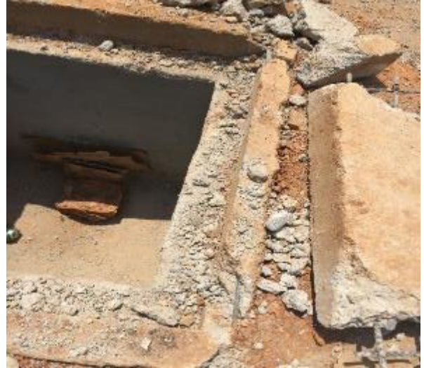
TL-23 con daño visible en casquete y tapadera
