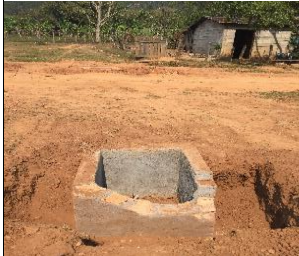
Terminal de Limpieza muy dañada.
