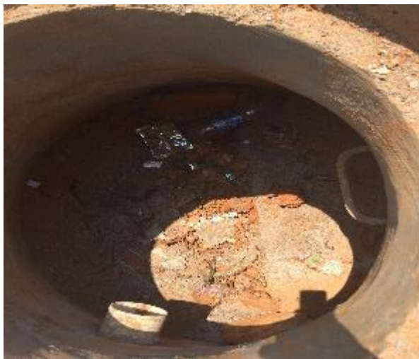
Pozo sin tapadera totalmente expuesto a la intemperie
