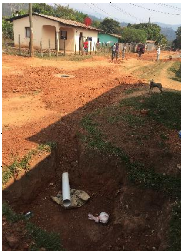
Caja Domiciliaria, únicamente excavada y con su tubería instalada. Se Observa pozo sin tapadera
