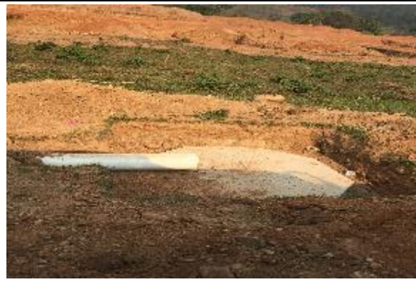
Pozo P-165 A previo al ingreso a las lagunas de Oxidación, en proceso de Construcción.
