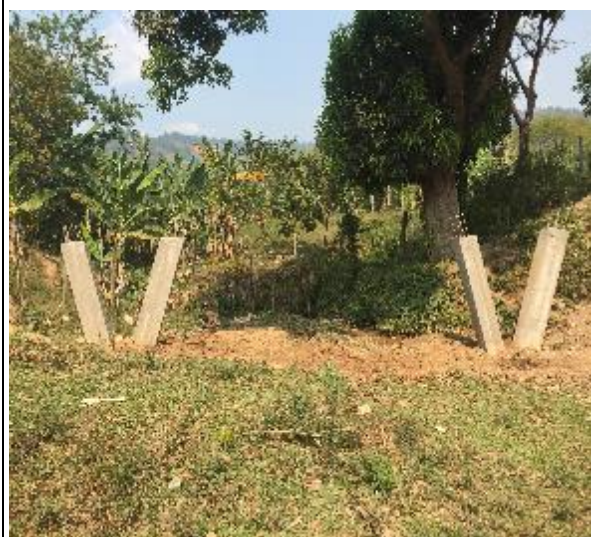
Columnas para cruce aéreo de tubería.
