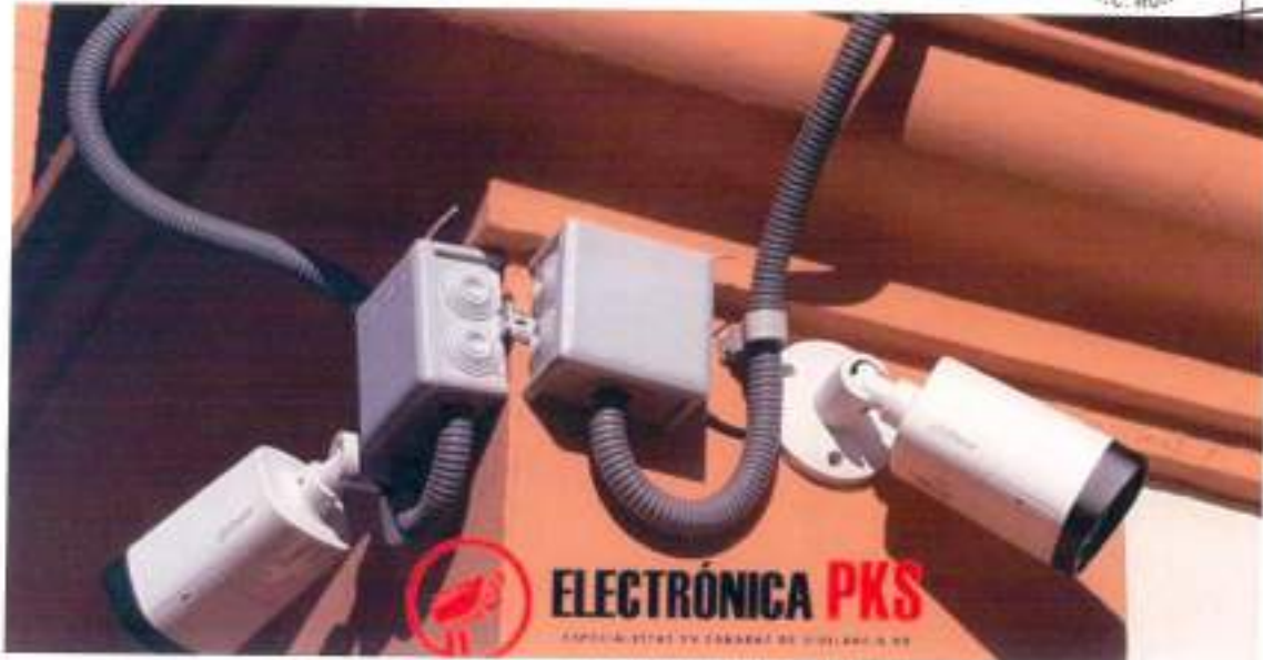
Ejemplo de canalización y utilización de cajas de conexiones
