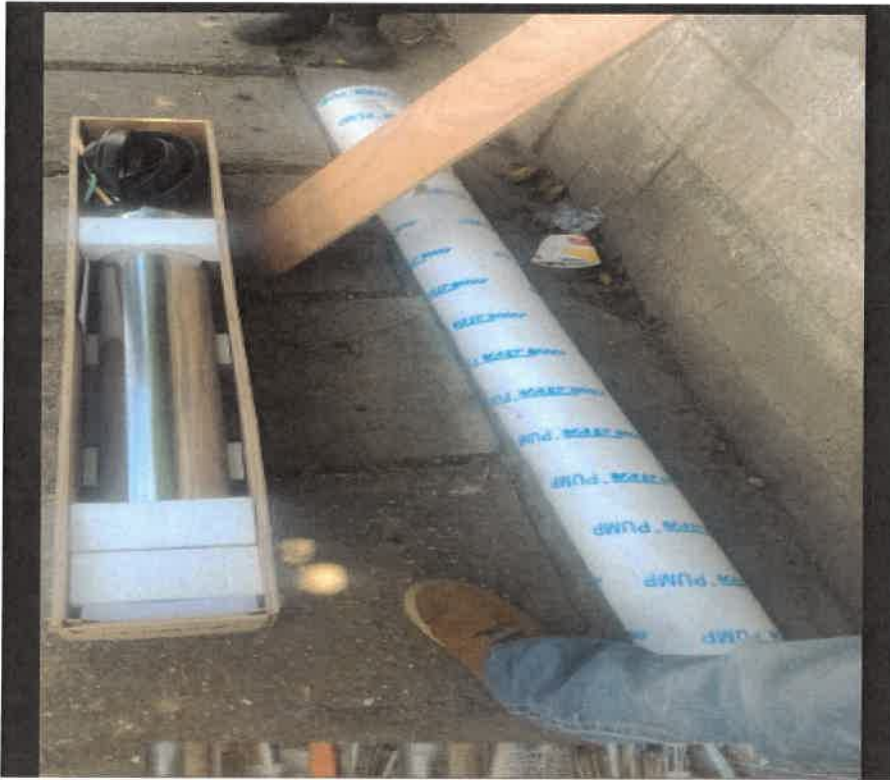
BOMBA Y MOTOR SUMERGIBLE DE 40HP MASTRA PARA POZO VISTA HERMOSA
