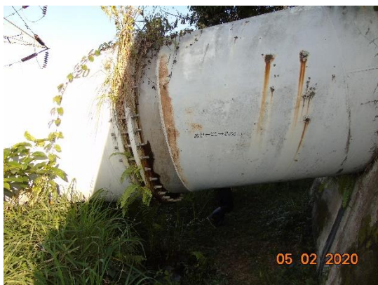
Penstock No. 2 de la C.H. Río Lindo (Juntas de montaje tipo dresser Túnel de aire forzado) Unidad 4
