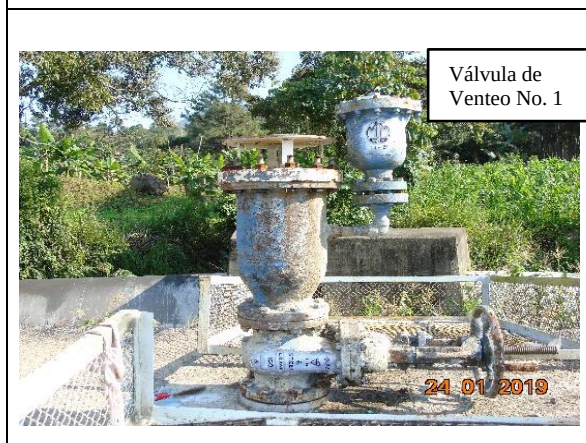
Válvula de Venteo No. 1 en el Segmento 200
