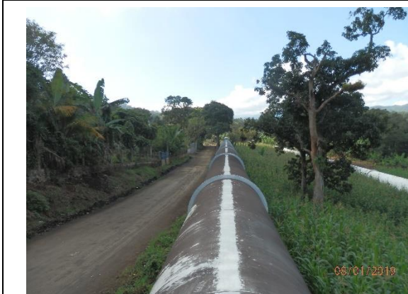
Tuberías Presurizadas y Torres de Oscilación de la Central Hidroeléctrica Río Lindo (Vista de la Tubería Presurizada No.1 desde la Torre de Oscilación No.1)
