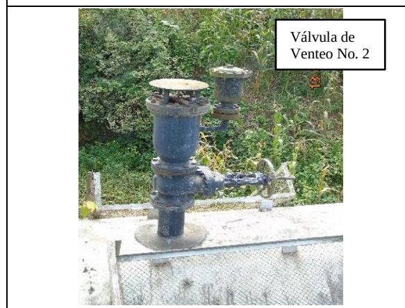
Válvula de Venteo No. 2 en el Segmento 300
