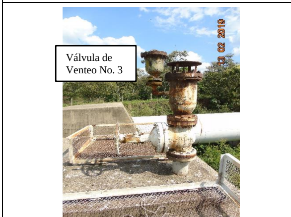
Válvula de Venteo No. 3 en el Segmento 600
