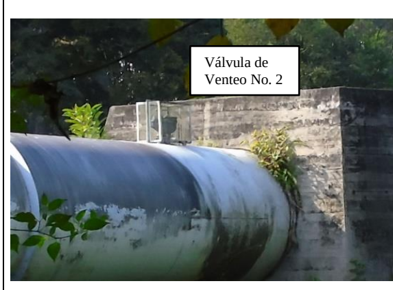
Válvula de Venteo No. 2 en el Segmento 201
