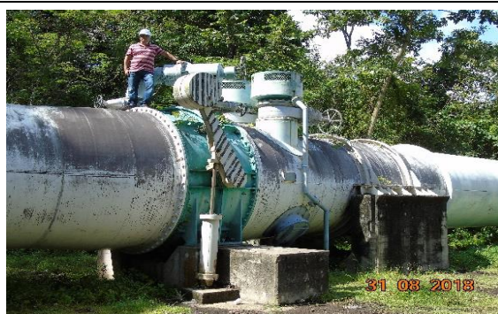
Válvula de Penstock No. 2 (Válvula Mariposa) (Vista desde la válvula de penstock No. 1)
