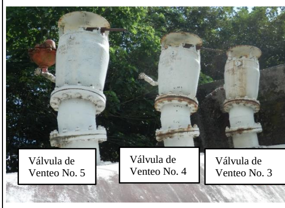
Válvulas de venteo No. 3, No. 4 y No. 5 en el segundo grupo
