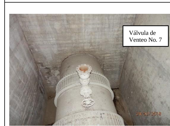
Válvula de Venteo No. 7 en el Segmento 2004
