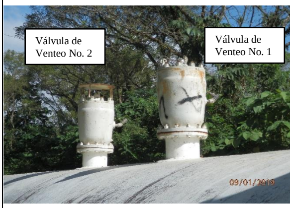
Válvulas de venteo No. 1 y No. 2 en el Primer Grupo
