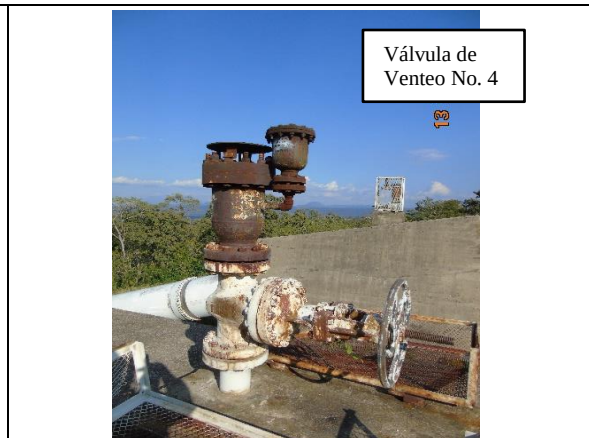
Válvula de Venteo No. 4 en el Segmento 1300
