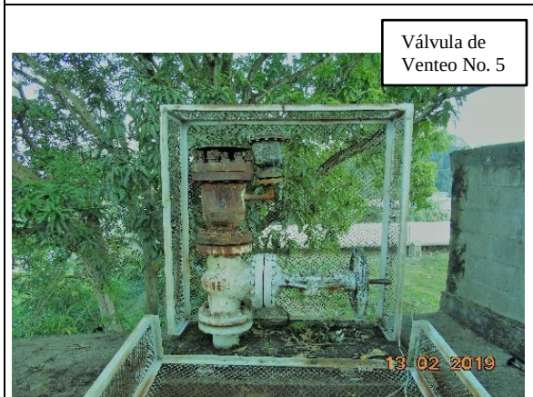
Válvula de Venteo No. 5 en el Segmento 1900
