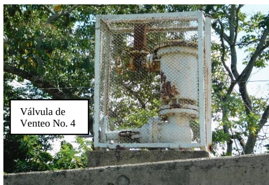
Válvula de Venteo No. 4 en el Segmento 1800
