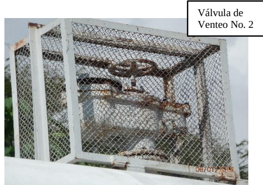
Válvula de Venteo No. 2 en el Segmento 801
