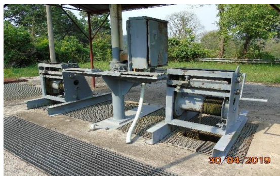
Estructura de Control de Río Lindo (Mecanismo de Operación con Motor tipo Tornillo sin Fin)
