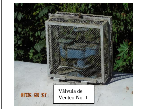
Válvula de Venteo No. 1 en el Segmento 1
