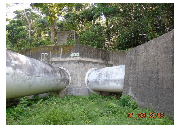
Tuberías Presurizadas y Torres de Oscilación de la Central Hidroeléctrica Río Lindo (Punto de Bifurcación No. 1 y No. 2)
