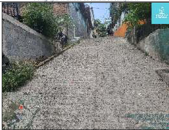
Fotografía 6: Estado de cuneta en callejón 6.
