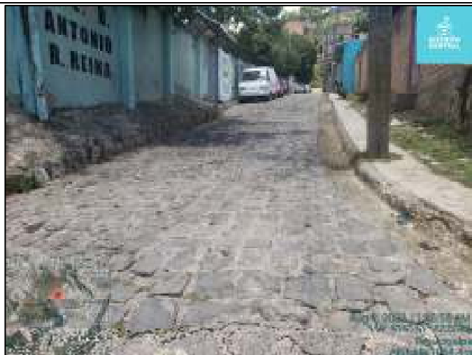
Fotografía 1: Estado de cuneta en callejón 1.
