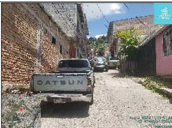
Fotografía 4: Estado de cuneta en callejón 4.
