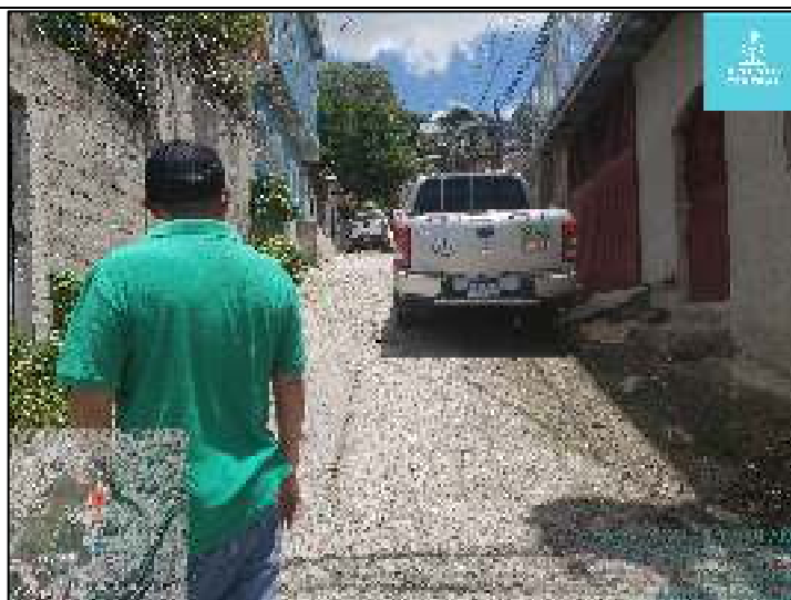
Fotografía 5: Estado de cuneta en callejón 5.
