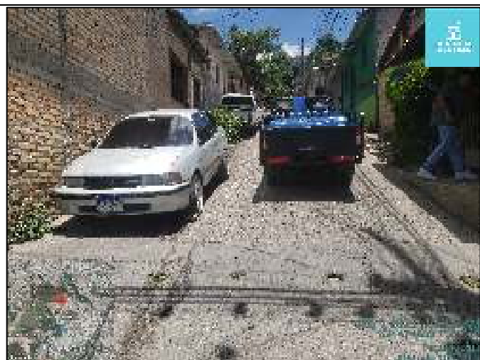
Fotografía 3: Estado de cuneta en callejón 3.
