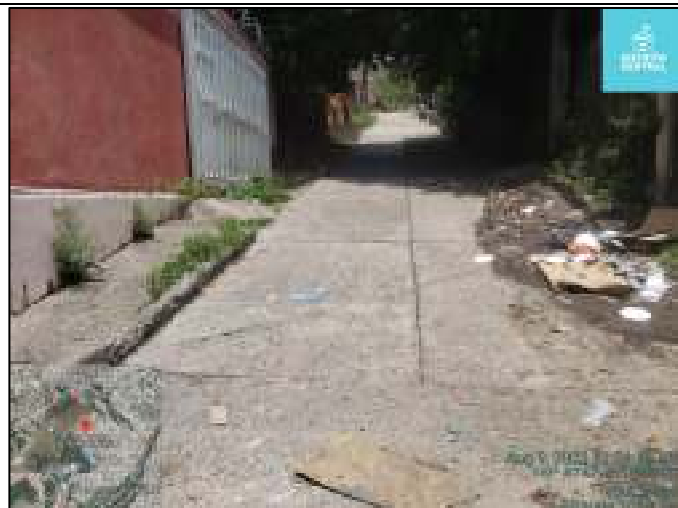
Fotografía 2: Estado de cuneta en callejón 2.
