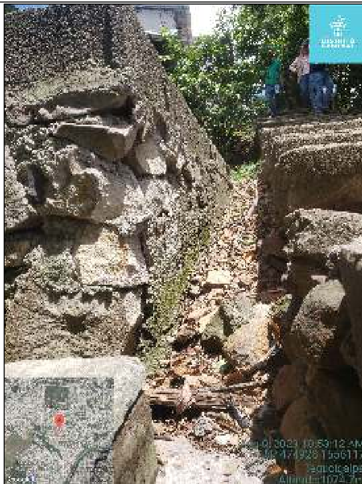
Fotografía 8: Estado de cuneta en callejón 8.
