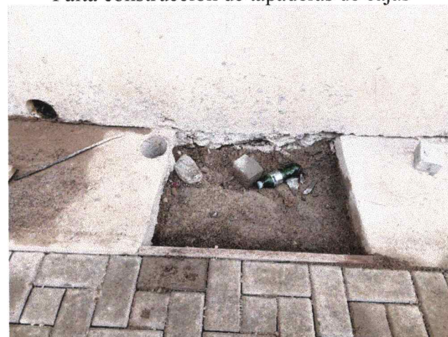
Falta construcción de tapaderas de cajas
