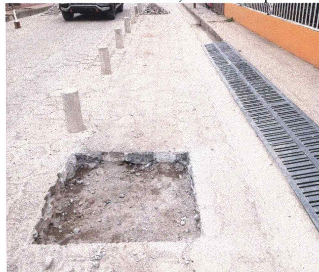
Falta Sembrar árboles, instalar adoquín
