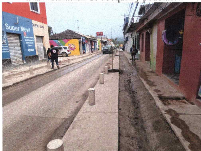
Falta instalación de adoquín y podotáctil
