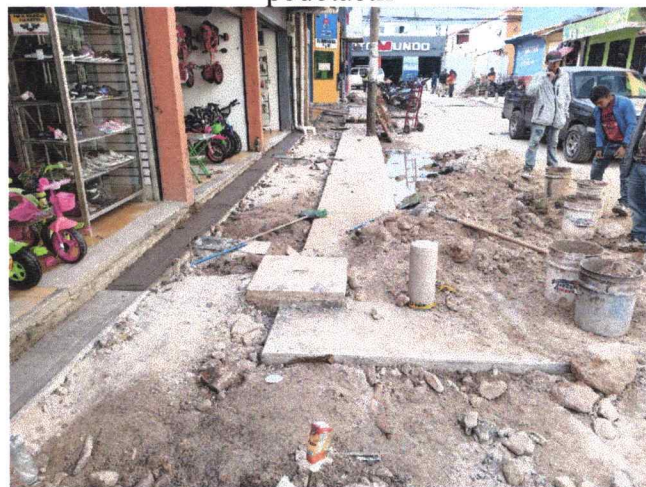
Frente a Tiendas La Esperanza falta adoquín y podotáctil
