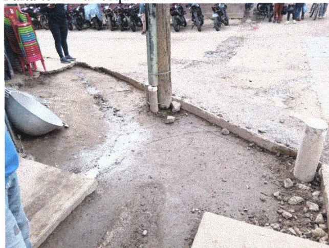
Falta terminar esquinas en intersecciones de calles
