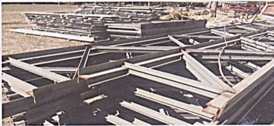
Armado de Joist con cuerda superior e inferior de ángulo doble de 2"x3/16 y diagonales reforzadas de ángulo doble intercalado de 1"1/8" a 45°@ 1 metro
