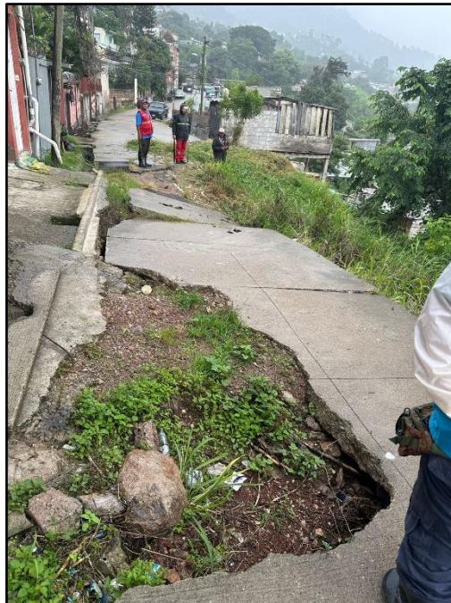
Ilustración 6. El deslizamiento afecta una sección inclinada, comprometiendo la estabilidad de la cera y el terreno adyacente.
