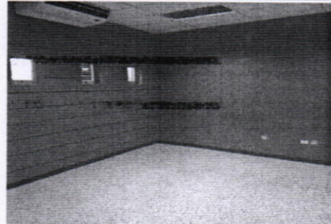
Vista del avance el area de computadoras
