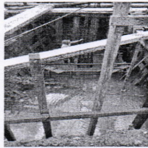
Vista de infiltracion de aguas subterranas en las excavaciones de las zapatas (20-12-2016)
