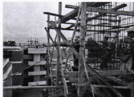
Armado y encofrados para cuarto de máquinas de cubo de elevador F1
