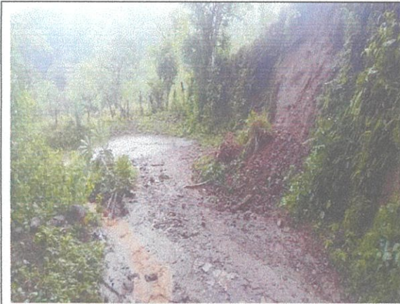
IMAGEN 5: Derrumbé en caserío la cuesta comunidad los Amates.
