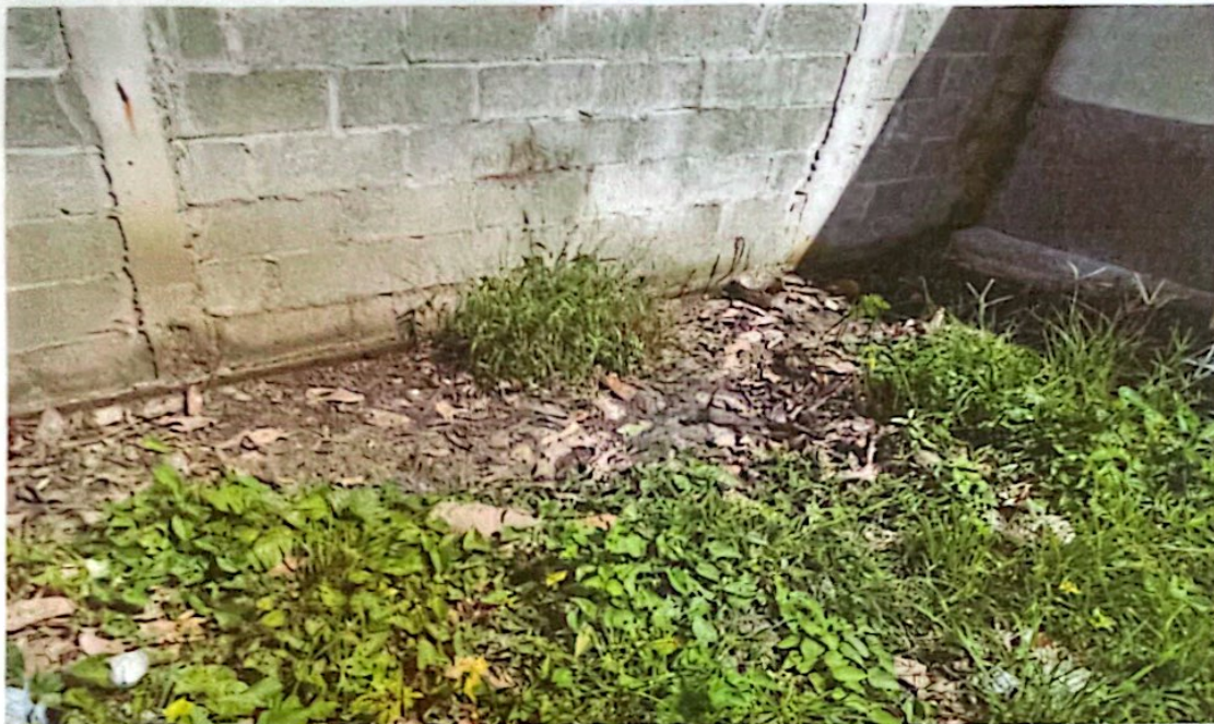
Atención de denuncia por contaminación de aguas negras, cementerio
