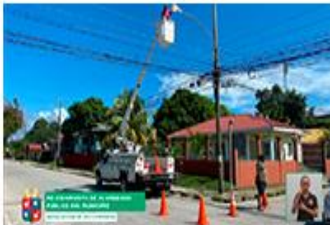
MEJORAMIENTO ALUMBRADO PÚBLICO DEL MUNICIPIO
