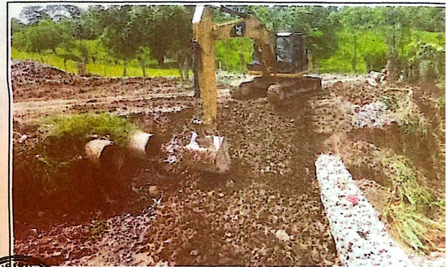
CONSTRUCCIÓN DE CAJA PUENTE EN CRUCE DE QUEBRADA ENTRE LAS COMUNIDADES DE EL TESORO Y FLORES, EN EL MUNICIPIO DE EL PARAISO COPAN
