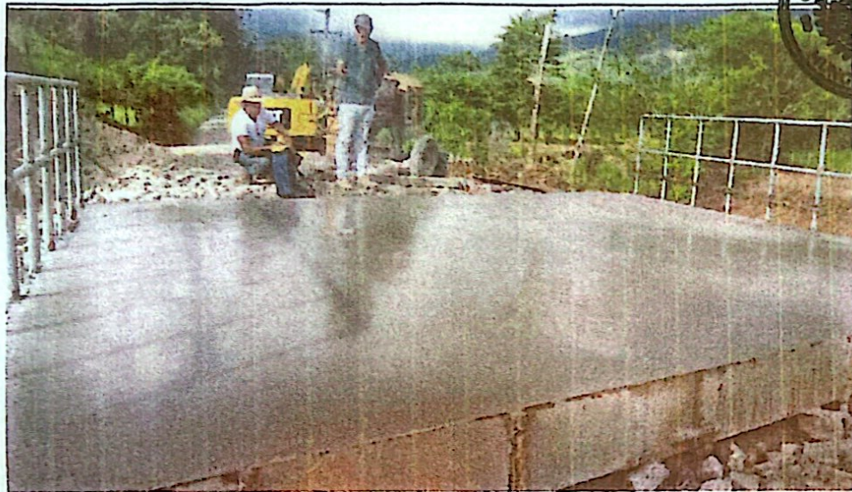
CONSTRUCCIÓN DE CAJA PUENTE EN CRUCE DE QUEBRADA ENTRE LAS COMUNIDADES DE EL TESORO Y LAS FLORES, EN EL MUNICIPIO DE EL PARAISO COPAN
