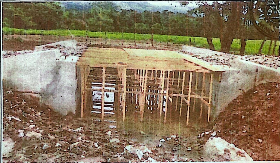
CONSTRUCCIÓN DE CAJA PUENTE EN CRUCE DE QUEBRADA ENTRE LAS COMUNIDADES DE EL TESORO Y LAS FLORES, EN EL MUNICIPIO DE EL PARAISO COPAN
