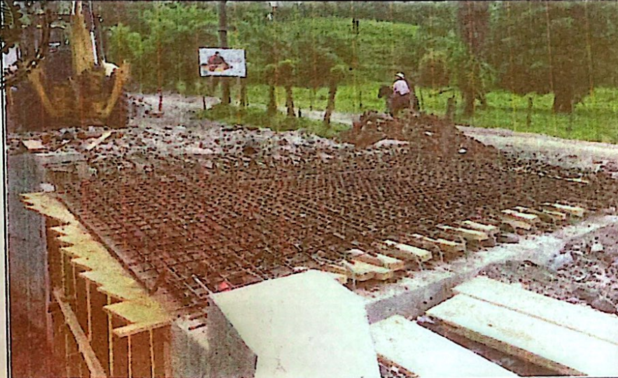
CONSTRUCCIÓN DE CAJA PUENTE EN CRUCE DE QUEBRADA ENTRE LAS COMUNIDADES DE EL TESORO Y LAS FLORES, EN EL MUNICIPIO DE EL PARAISO COPAN
