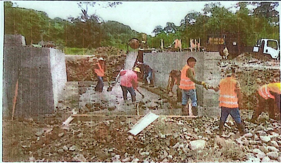
CONSTRUCCIÓN DE CAJA PUENTE EN CRUCE DE QUEBRADA ENTRE LAS COMUNIDADES DE EL TESORO Y LAS FLORES, EN EL MUNICIPIO DE EL PARAISO COPAN
