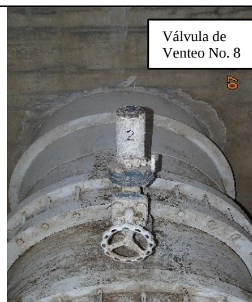
Válvula de Venteo No. 8 en el Segmento 2204
