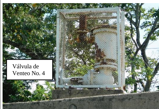
Válvula de Venteo No. 4 en el Segmento 1800
