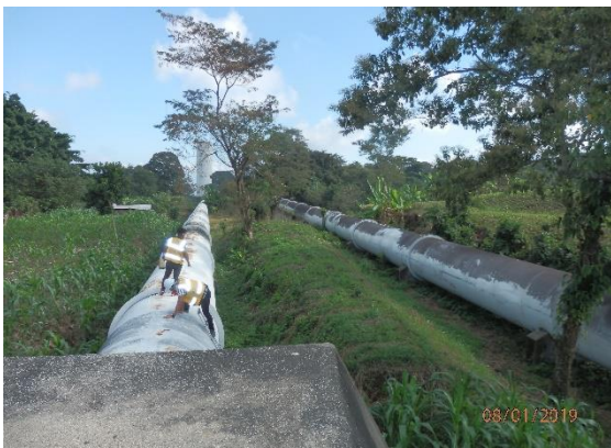
Tuberías Presurizadas y Torres de Oscilación de la Central Hidroeléctrica Río Lindo (Vista de Torre de Oscilación No.1)
