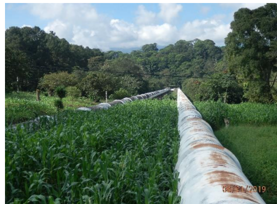
Tuberías Presurizadas y Torres de Oscilación de la Central Hidroeléctrica Río Lindo (Vista de Torre de Oscilación No.2)
