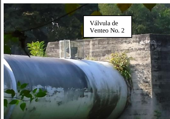
Válvula de Venteo No. 2 en el Segmento 201
