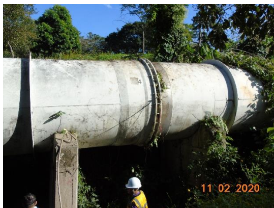
Penstock No. 2 de la C.H. Río Lindo
