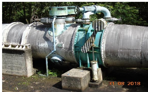
Válvulas de Expulsión de Aire/Rompe-Vacío No. 2 (Vista del Lado Aguas-Abajo)
