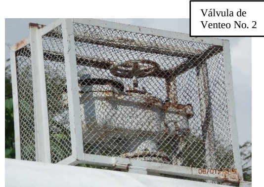
Válvula de Venteo No. 2 en el Segmento 801
