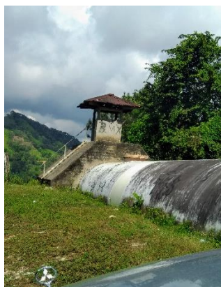
Penstock de la Central Hidroeléctrica Cañaverl (Vista hacia Casa de Máquinas desde Punto Alto)
