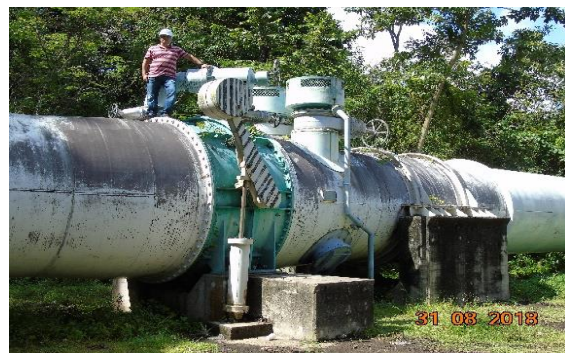
Válvulas de Bypass No. 1 (Vista desde la válvula de penstock No. 1)
