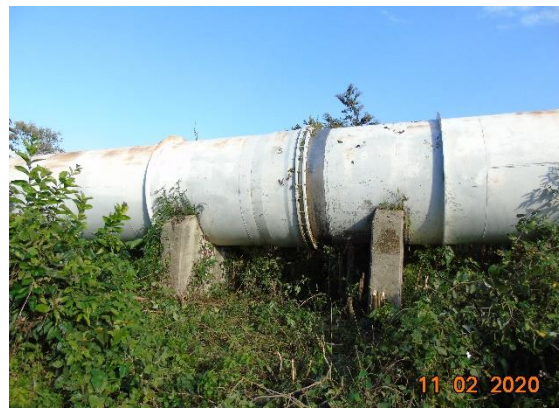
Penstock No. 2 de la C.H. Río Lindo
