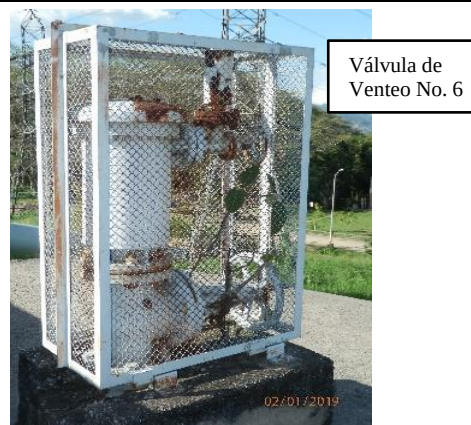
Válvula de Venteo No. 6 en el Segmento 2100
