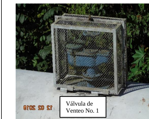
Válvula de Venteo No. 1 en el Segmento 1
