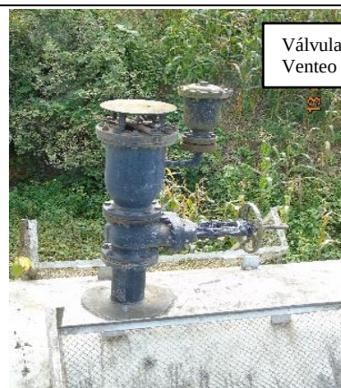
Válvula de Venteo No. 2 en el Segmento 300
