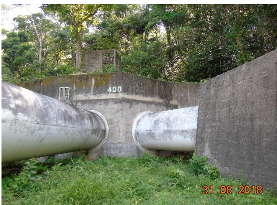
Tubería presurizada No. 1 a la derecha y No. 2 a la izquierda de la Central Río Lindo (Vista hacia las Torres de Oscilación)
