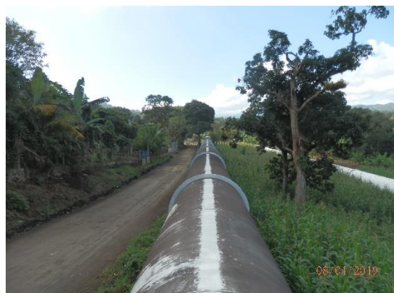
Tubería presurizada No. 2 Central Rio Lindo (Vista desde la Torre de Oscilación No.1)
