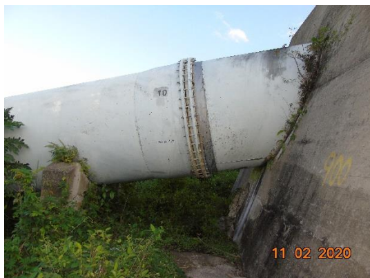
Penstock No. 2 de la C.H. Río Lindo
