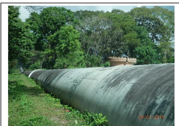
Penstock de la Central Hidroeléctrica Cañaverl (Vista desde Punto Alto hacia Bocatoma)
