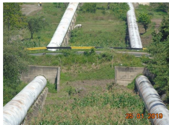
Torres de Oscilación: A la derecha: Torre No.1 y a la izquierda: Torre No.2
