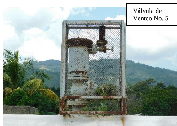
Válvula de Venteo No. 5 en el Segmento 2001
