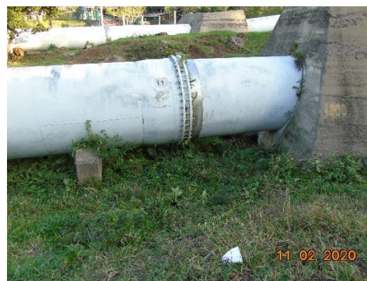
Penstock No. 2 de la C.H. Río Lindo
