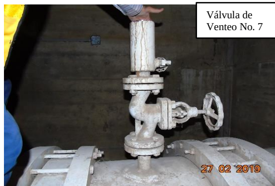
Válvula de Venteo No. 7 en el Segmento 2211
