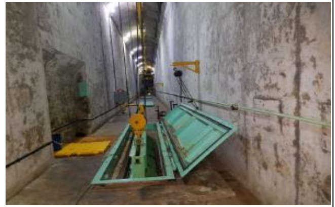
Viga Pescante Sosteniendo la Compuerta (Ataguía)
