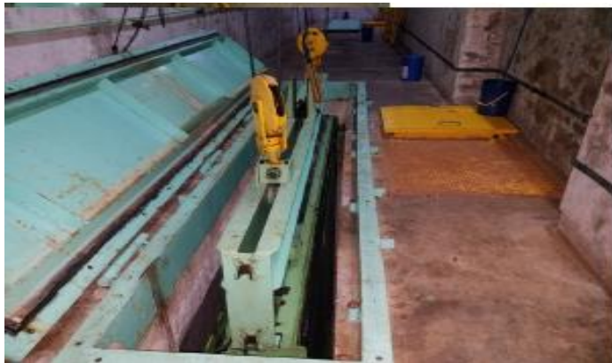
Acercamiento de la Viga Pescante Sosteniendo la Compuerta (Ataguía)
