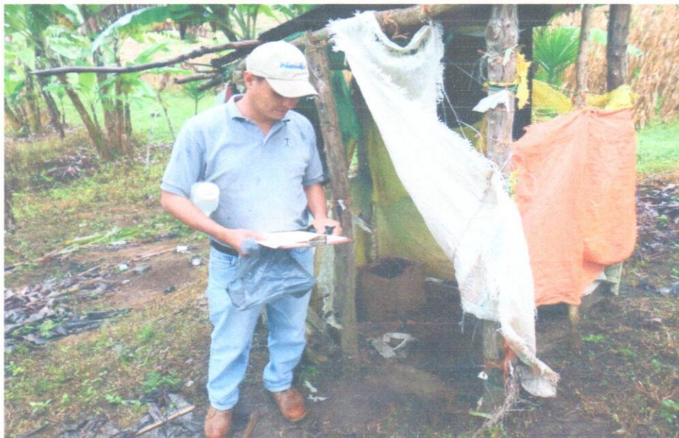
Fotografía No.1: Situación de las letrinas en mal estado y que se tiene previsto construirlas nuevas
