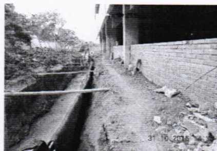
Subdrenaje en lado sur
