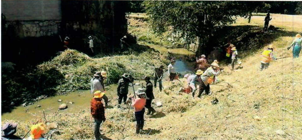
Dragado, limpieza y canalización de la quebrada La Orejona, Atrás del Bazar del Sábado. Blvd Juan Pablo II
