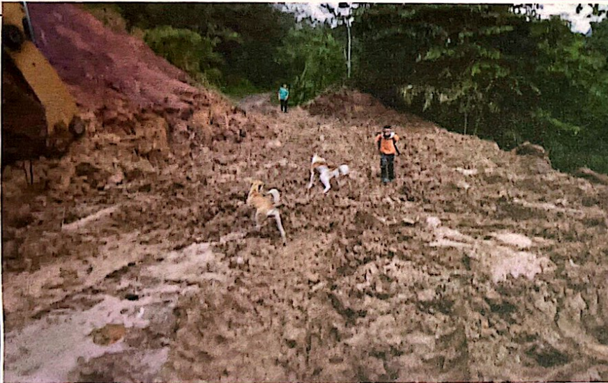
REMOCION DE DERRUMBES, BACHEO O RELLENO CON MATERIA DE RIO TIPO CASCAJO, EN PASOS DAÑADOS POR LLUVIAS, EN TRAMO CARRETERO, EL PARAISO - LA LAGUNA, EN EL MUNICIPIO DE EL PARAISO COPAN
