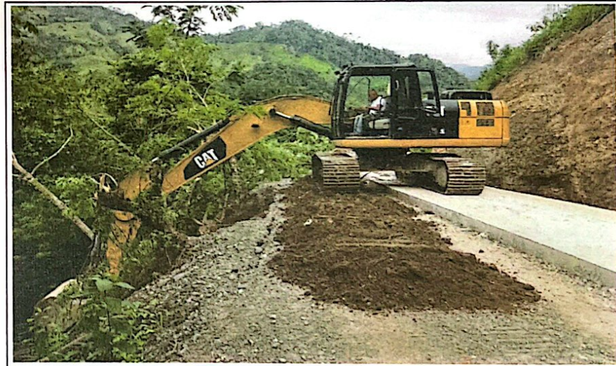
REMOCION DE DERRUMBES, BACHEO O RELLENO CON MATERIA DE RIO TIPO CASCAJO, EN PASOS DAÑADOS POR LLUVIAS, EN TRAMO CARRETERO, EL PARAISO - LA LAGUNA, EN EL MUNICIPIO DE EL PARAISO COPAN
