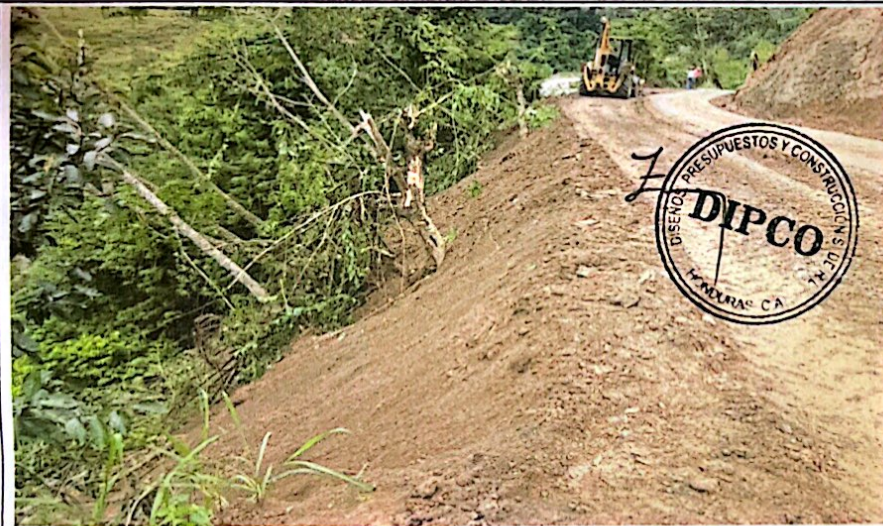
REMOCION DE DERRUMBES, BACHEO O RELLENO CON MATERIA DE RIO TIPO CASCAJO, EN PASOS DAÑADOS POR LLUVIAS, EN TRAMO CARRETERO, EL PARAISO - LA LAGUNA, EN EL MUNICIPIO DE EL PARAISO COPAN
